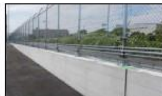
海岸保全施設（止水壁）
