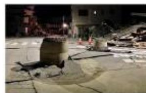
マンホール浮上（輪島市）
